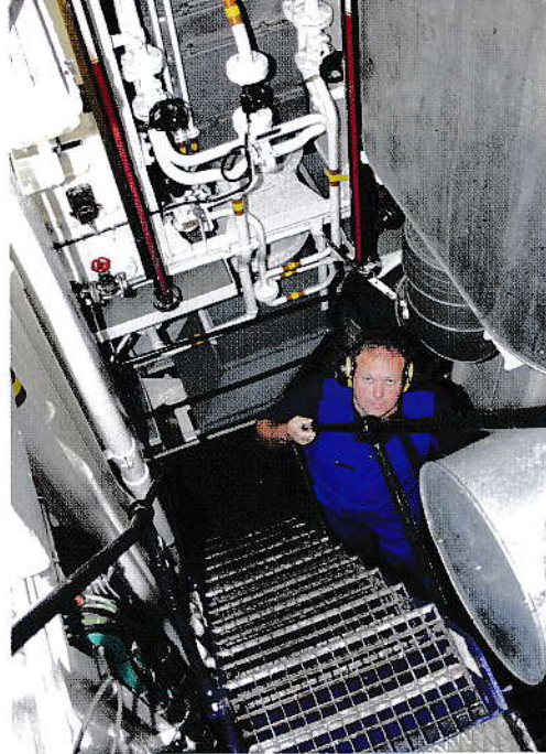
Drei Stockwerke hinunter geht es in den Maschinenraum, das Reich vom „Chief“, Oberleutnant zur See Jens Vollertsen
